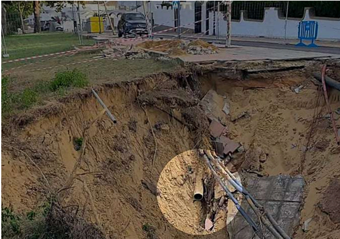
La canalización rota. (IG)
