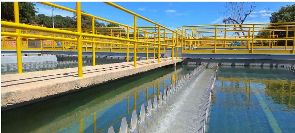
Planta de tratamiento de Villa del Rosario. / Foto: Aqualia.
